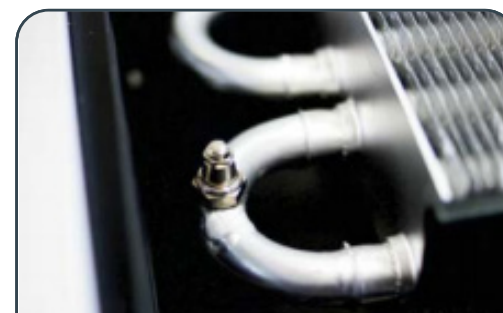
Zračni ventil na toplotnem izmenjevalniku
